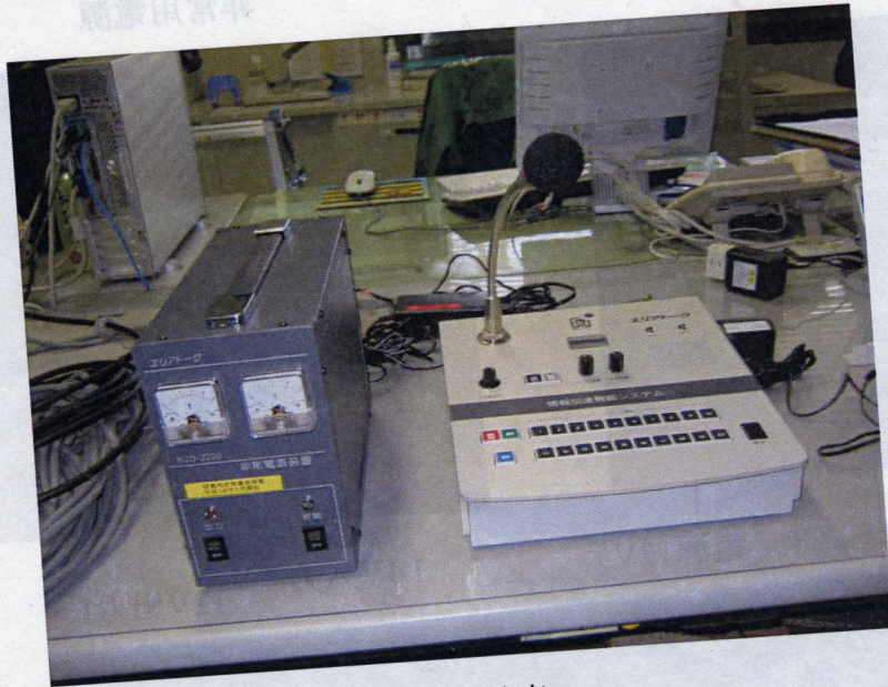
非常用電源、放送卓
